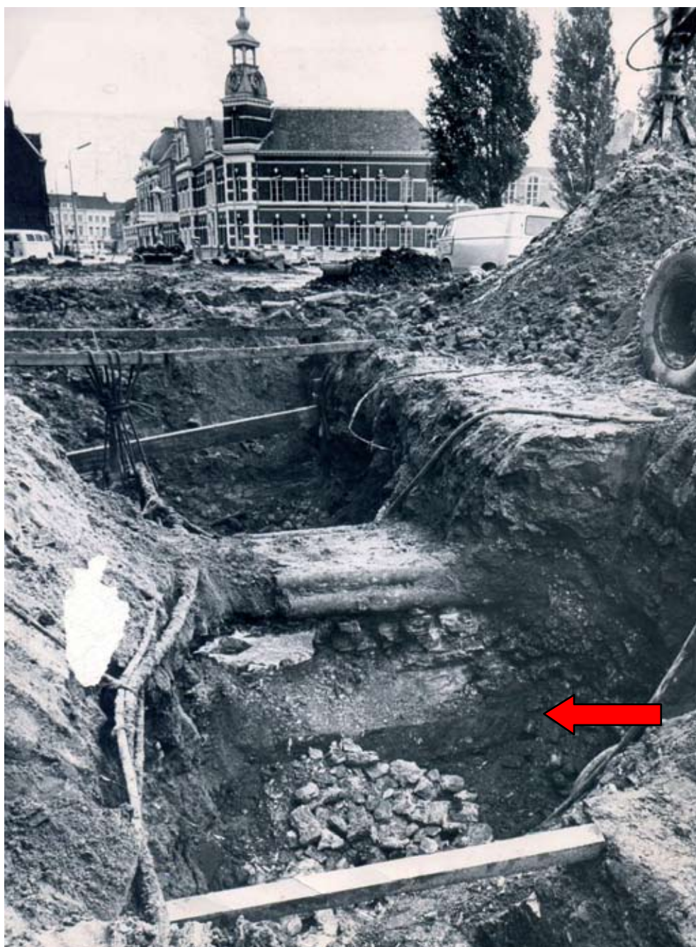
Afb. 9 Onder de kabels en leidingen is de muur te zien, zie rode pijl. Foto: archief BN/ DeStem fotograaf: Ben Speekenbrink
