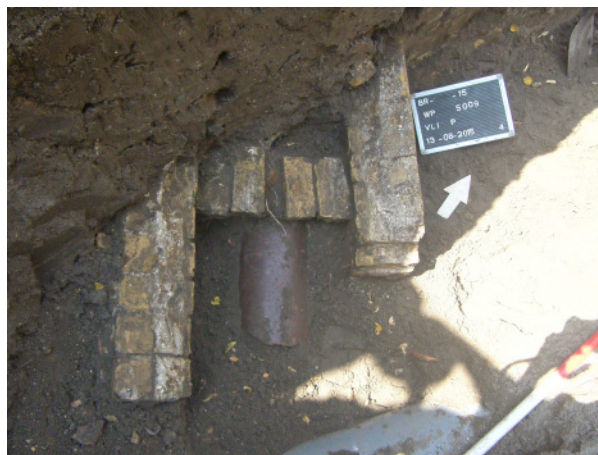
Afb. 38. Links Voorbeeld van een dichtgemetselde zijtoevoer in het historisch riool. Foto genomen in het geres-taureerde riool t.h.v. de Houtmarkt.
