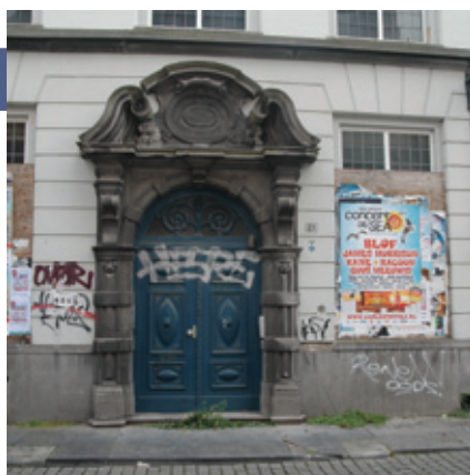
De huidige situatie van de panden in de Nieuwstraat: dichtgespijkerde ramen en vol met graffiti.
