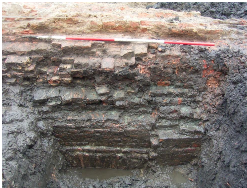
Afbeelding 16: Spaarbogen onderin de jongere fase van de stadsmuur (S102) en verzakking.
