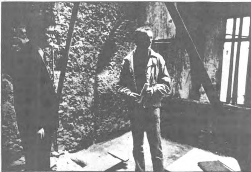
◆ Waar bouwhistoricus Dick Zweers (r.) restanten van een 16de-eeuws pand verwachtte aan te treffen in Breda, blijken waardevolle delen van een middeleeuws klooster in en onder een slooppand te zitten. Wethouder Adank van monumentenzaken en de andere leden van het gemeentebestuur zijn er verrukt over.
